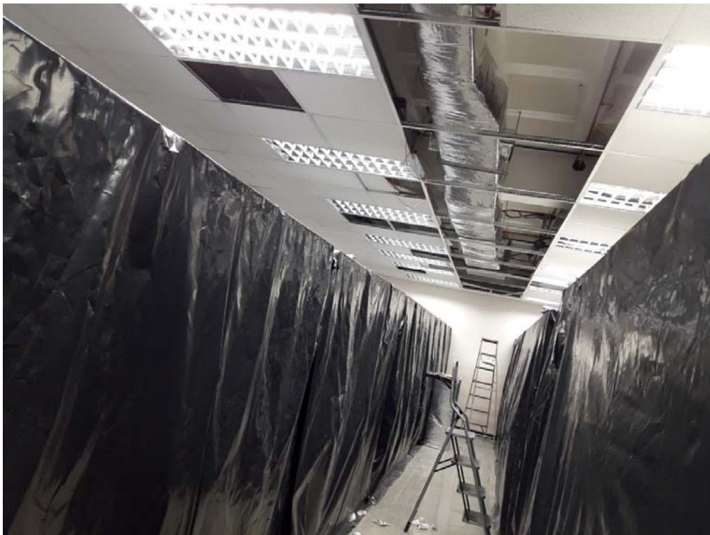
Implementación del Sistema de Circulación de Aire, para la óptima conservación de los documentos que se encuentran en el Archivo Intermedio (AI). 19/04/2017
